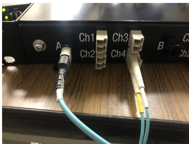
図 30 オプティカルファイバー同士の変換を行っている。
