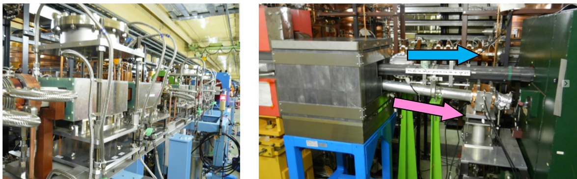
図 2.7 アボートキッカー電磁石 (左図) と、ビームダンプ (右図) の写真 [10]。右図において水色の矢印がメインリングの蓄積ビームが通る方向、ピンク色の矢印がビームダンプに向かうビームが通る方向を示し、右側の緑色の物体がビームダンプである。
