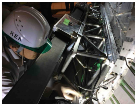
図 2.4: インストールの様子2。TOP カウンターをECL フランジにボルトで取り付けている様子。
