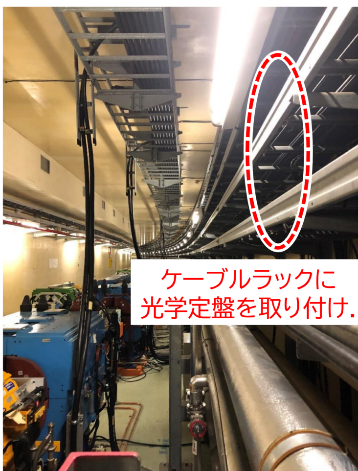
図 4.1.2 SuperKEKB 加速器トンネル内、LS1 期間中に D05 区域へインストールされた NLC (Non Liner Collimator) 部から D07 区域のアポートキッカー電源直下間の現場の様子。赤い点線で囲んでいる部分はケーブルラック。
